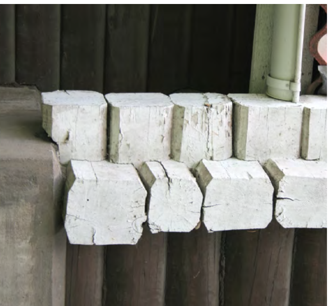
Pölkkipäädyn läns-pohjoismurkka. Ruskeapintainen 100-vuotias pyöröihispinta on suorastaan yllättävän hyväkuntoinen. Valkoisesti maalattujen nurkitten maali hisseilee paikoin paikoin, mutta vakarampia vaurioita ei nyt (9/2006) havaittu.
