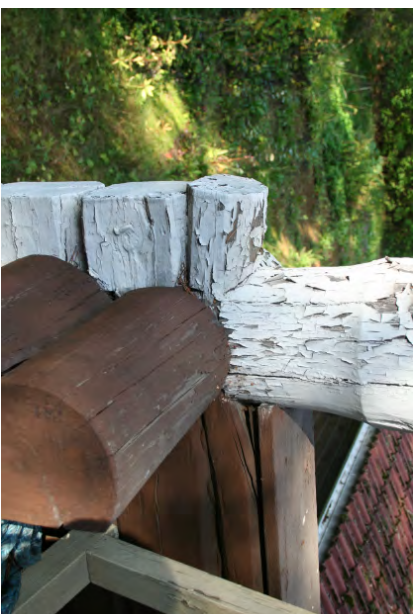
Länsiparvekkeen nurkkataplan liitoskotta. Auringon puolen hirret ja maalipinnat ovat heikosti vaurioituneen, varsinkin kohdissa missä puu on valia sadevettä.
