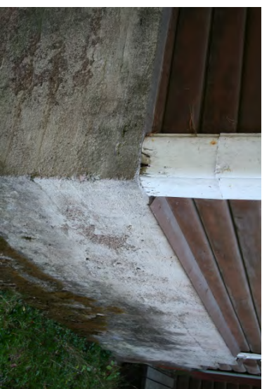
Saunan betoninen sokkeli. Todennäköisesti sekä saunasta sisästä tulevista että maasta nousevasta kosteudesta johtuen sokkeli on saamalan ja hommen peitossa.
