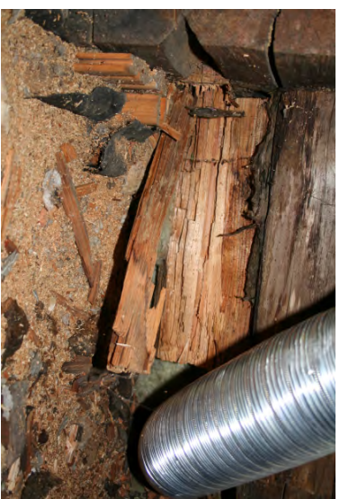
Lämmöneristämättömän poistoilmapiputki saunan yläpuolella olevalla ulakolla. Hirressä lahovaurion jälkiä.
