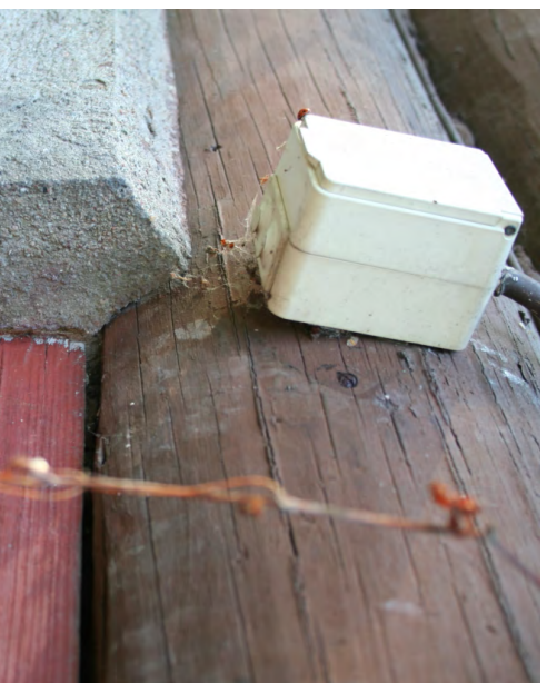
Sokkelin laastipinta ulottuu hirren päälle. Tämä kohta on potentiaalinen vaurioalue, mikäli valunavesi tai kosteus leääniy hirren alle. Sama asia myös keskikuvassa.
